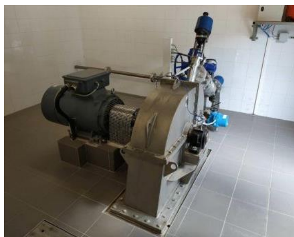
Turbine de la microcentrale hydroélectrique
