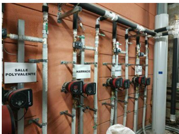
Réseau de la chaufferie biomasse
