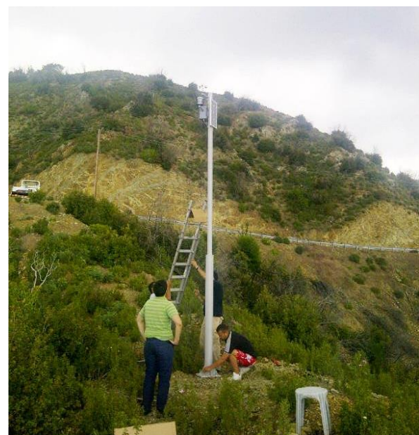
Installation d'une station météorologique dans les montagnes de Troodos. Crédits : Projet LIFE CALCHAS
